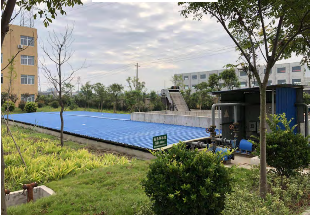
初期雨水收集池（事故池）
