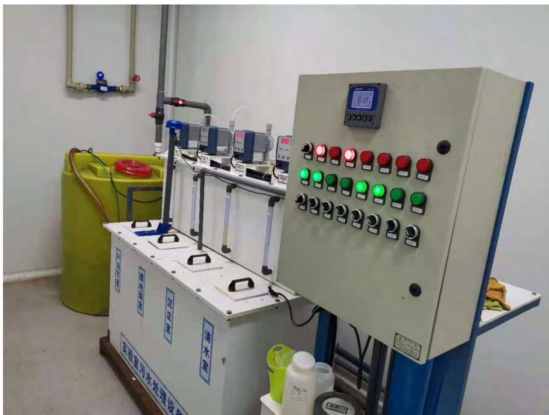
废水处理设施
